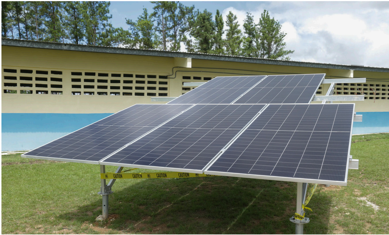
Paneles solares para electrificación rural.
